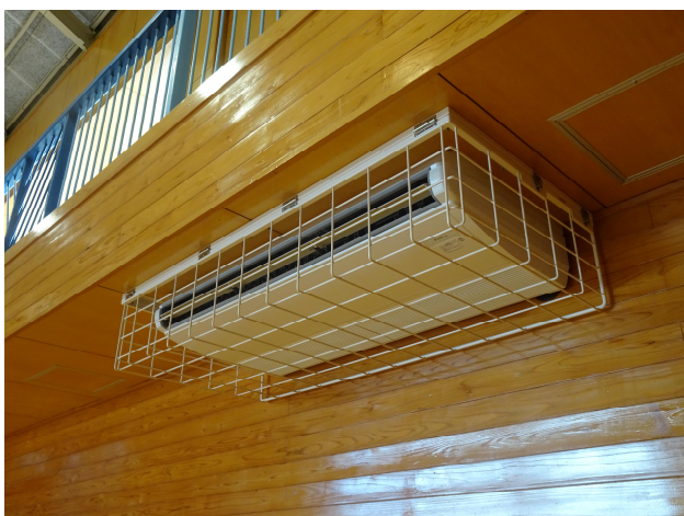
◇ 空調の機器は、体育館の北側と南側に各3台、計6台が設置されました。
