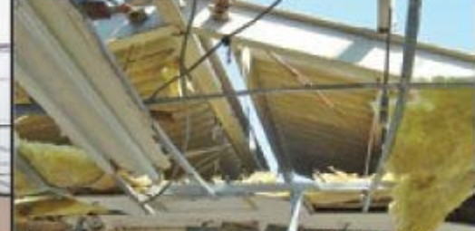
（独）建築研究所提供 2006.9 宮崎県延岡市
