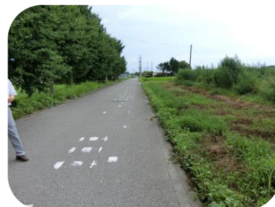
消えかかった道路標示
