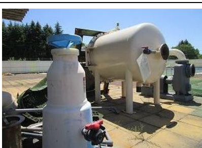
プールのろ過装置が新しく！
