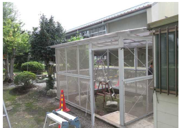
創立90周年記念事業の一環として、中庭の飼育小屋の建て替え工事が進んでいます。
